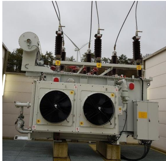
Transformateur de puissance
